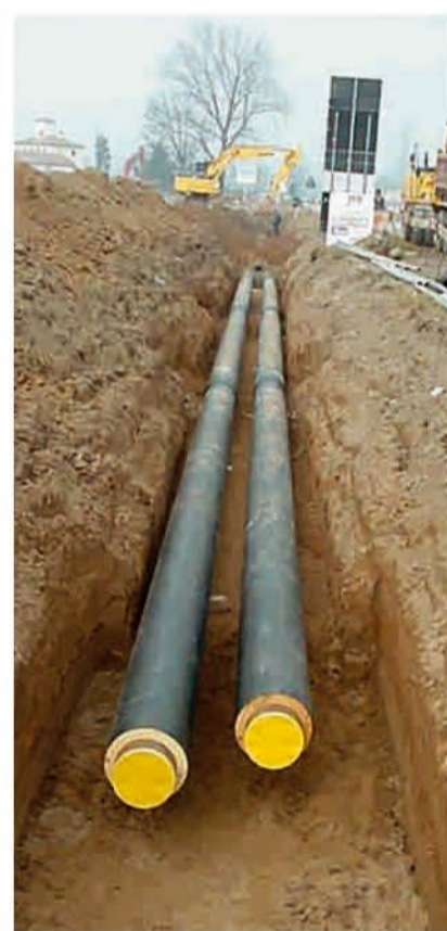
Rete di teleriscaldamento
