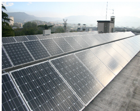
Azienda 25 kWp (TO)
