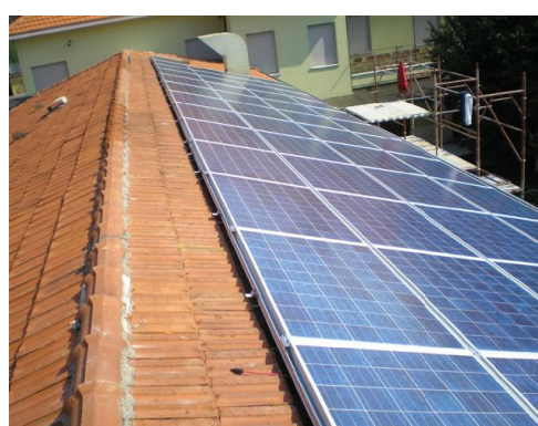
Cooperativa 10,4 kWp (VA)
