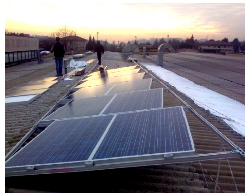
Azienda 15 kWp (CO)
