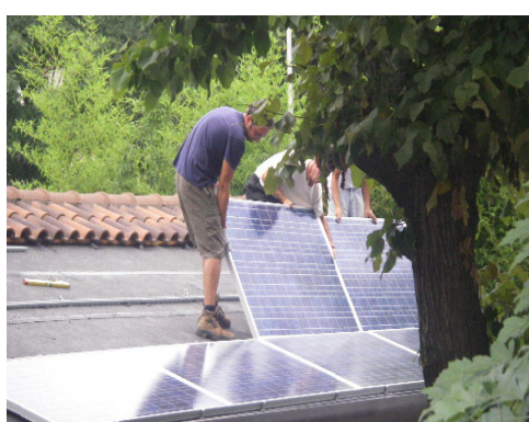
Privato 3,2 kWp (VA)
